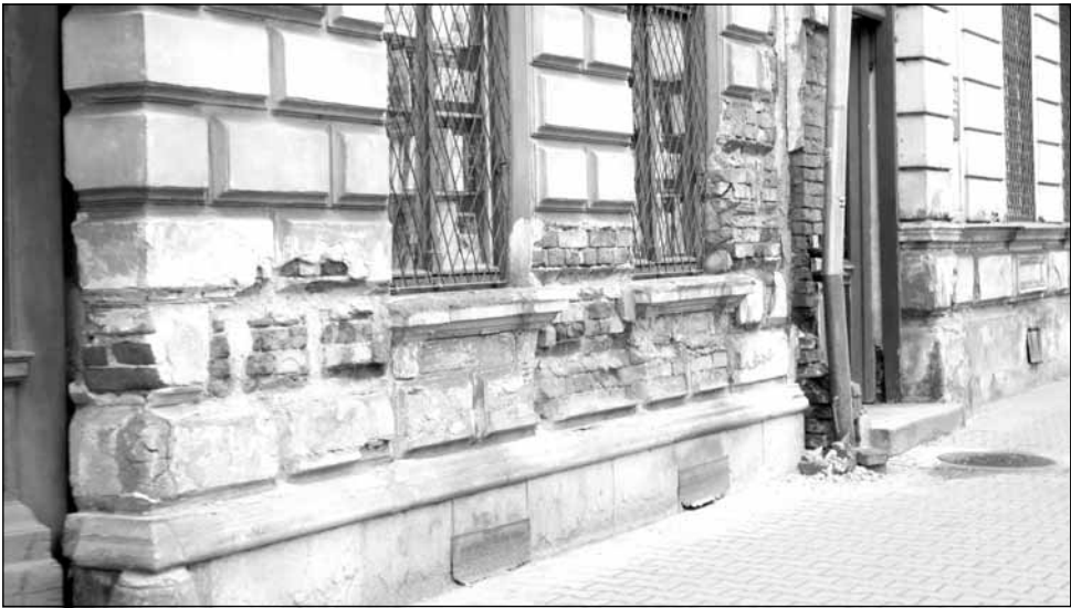
Zona centrală este plină de imobile degradate din care oricând pot să cadă bucăți de tencuială
