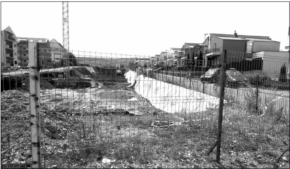
Locuitorii susțin că există riscul ca strada să se surpe
