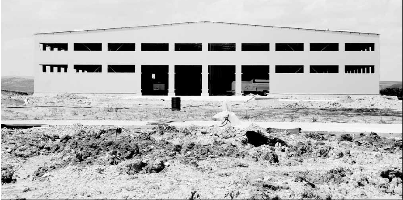
Tot ce s-a construit până în prezent la Centrul de Deșeuri ar trebui dărâmat
