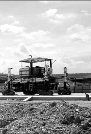
șantierul stă abandonat de aproape un an
