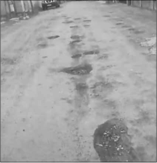
Strada plină de gropi și noroi din cartierul Bună Ziua va intra în lucrări de lărgire și asfaltare în primăvara anului viitor
