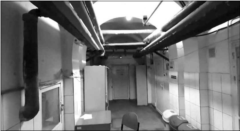
Mucegai, mizerie și aer îmbăcsit: condițiile din subsolul Spitalului Județean de Urgență Cluj
