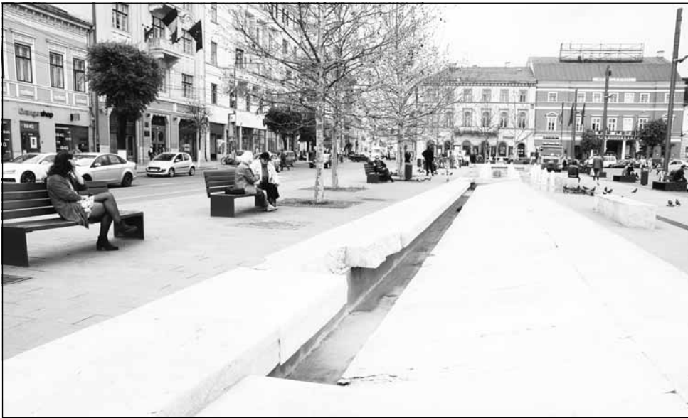
Fântâna din Piața Unirii s-a deteriorat aproape în fiecare an, din momentul în care a fost pusă în funcțiune, în 2009
