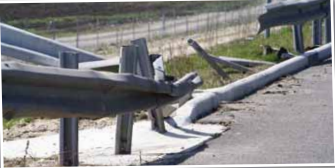
Parapet deteriorat pe o lungime de peste 10m, la km 259 pe sensul spre Sibiu
