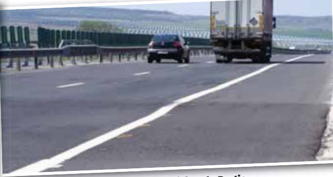
Denivelare periculoasă în zona podețului peste Pustia
