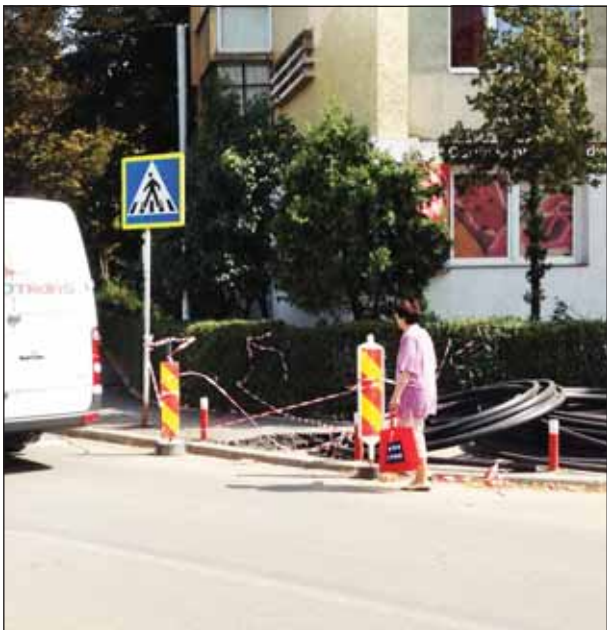
O femeie este obligată să circule pe partea carosabilă, printre mașini, din cauza cablurilor și săpăturilor de pe trotuare.
