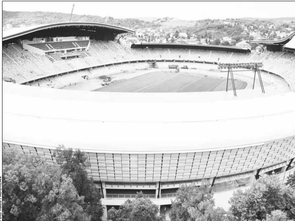
În aceste zile, lucrările la „Cluj Arena” se concentrează în special la finalizarea amplasării copertinei stadionului, la montarea scaunelor și la realizarea pistei de atletism.
